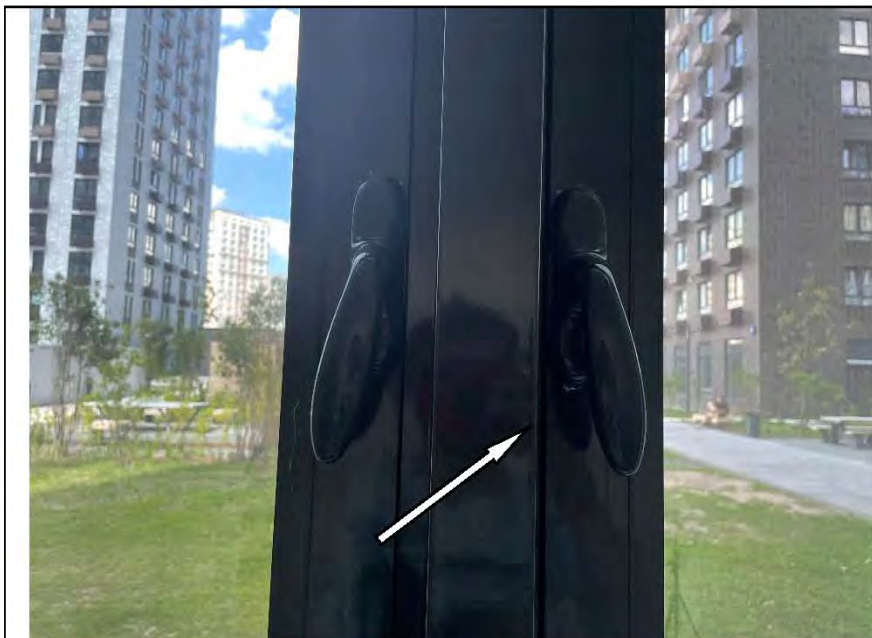
Фото №43. Фурнитура металлического оконного блока не отрегулирована в спальне.
