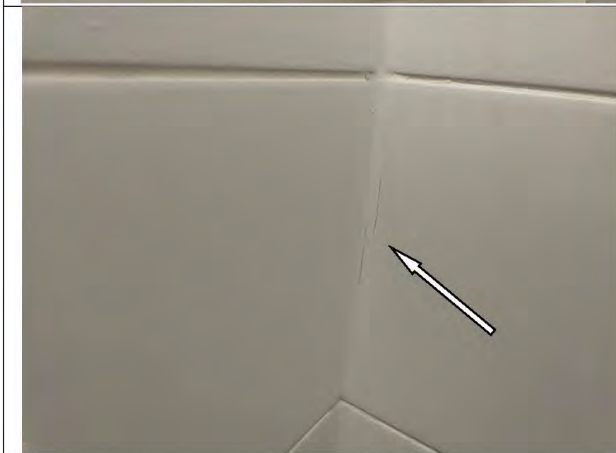
Фото №27. На настенной керамической плитке в санузле имеются дефекты (загрязнения).
