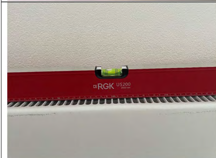
Фото №17. Отопительный прибор смонтирован неровно в спальне.
