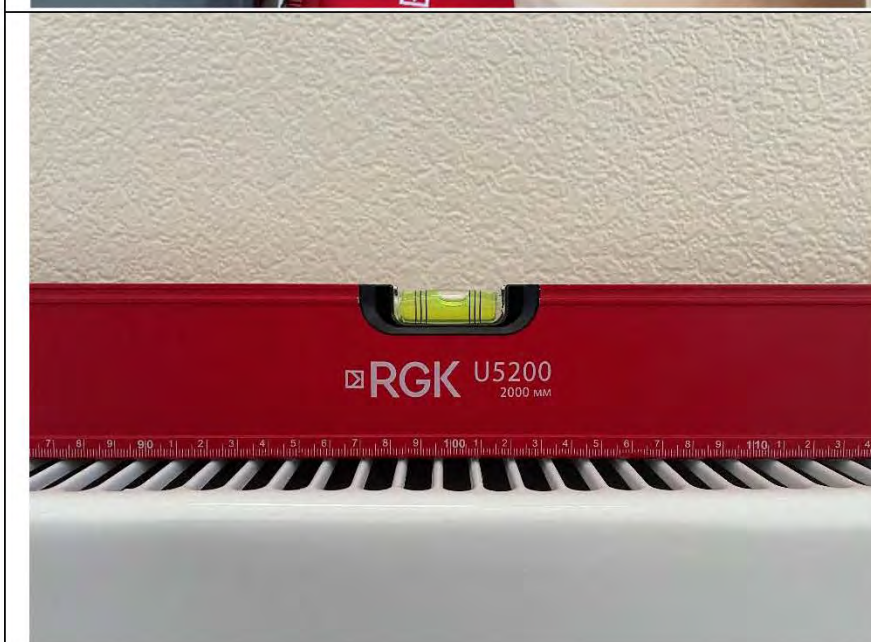
Фото №15. Отопительный прибор смонтирован неровно в кухне-гостиной.
