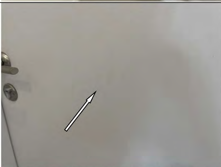
Фото №35. Полотно комбинированного входного дверного блока в коридоре имеет дефекты(загрязнение).
