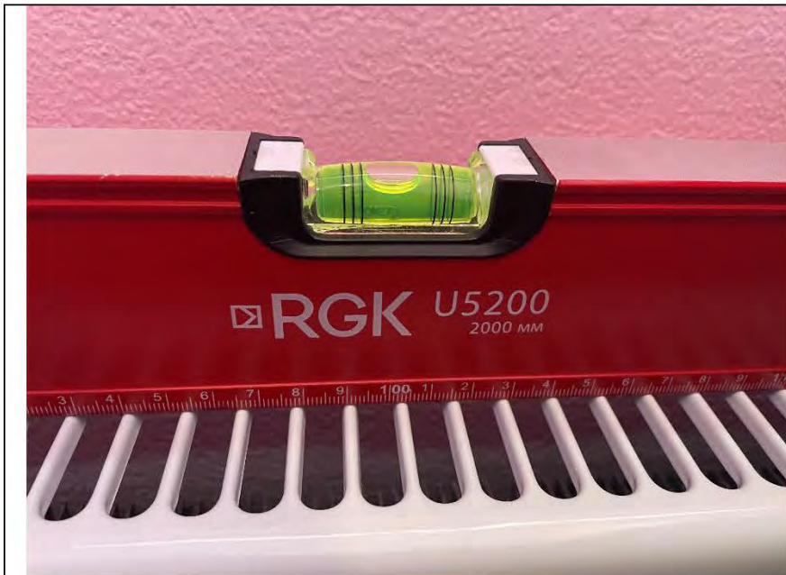
Фото №16. Отопительный прибор смонтирован неровно в детской.
