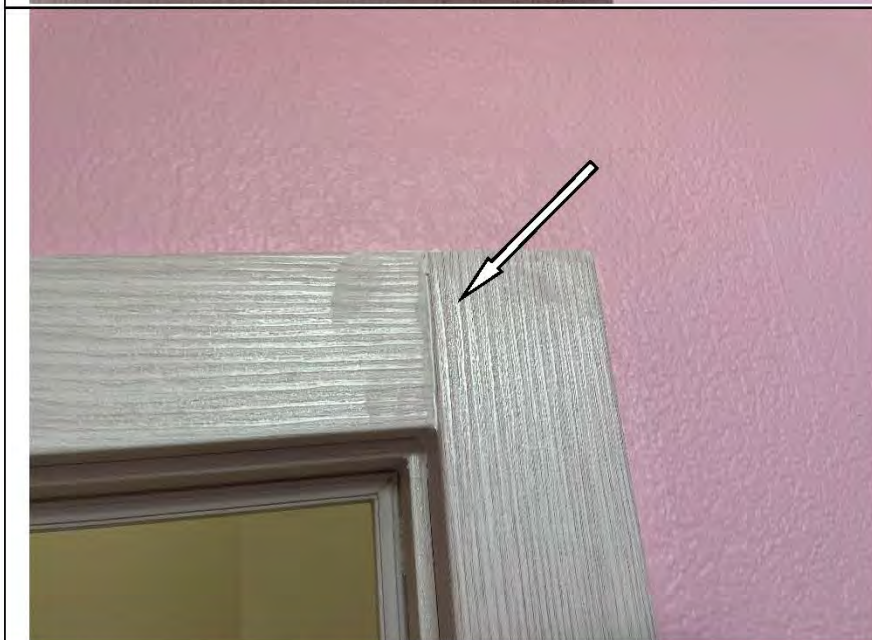
Фото №38. Некачественный стык дверного наличника к стене в детской.
