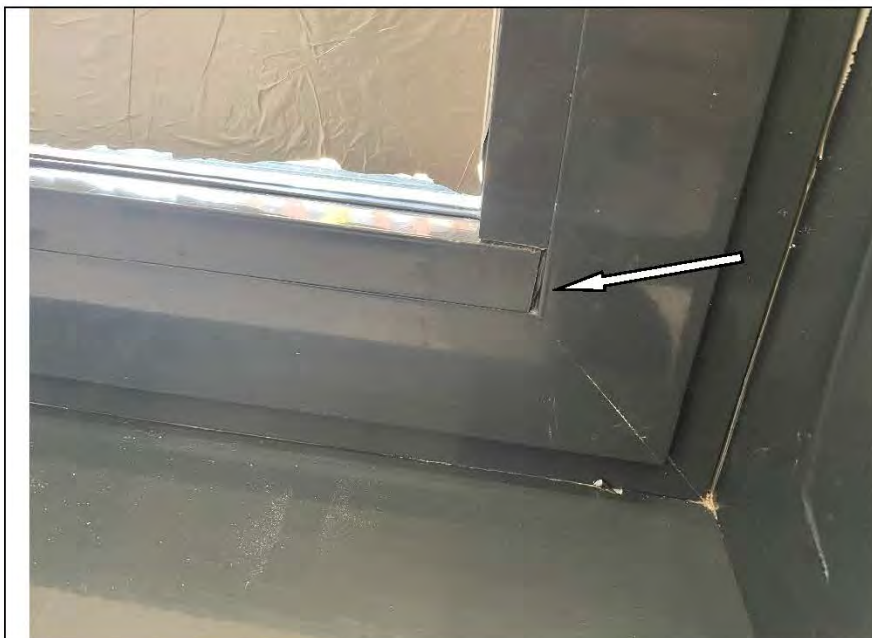
Фото №46. Дефекты на металлическом профиле оконного блока в кухне- гостиной (неаккуратное соединение).
