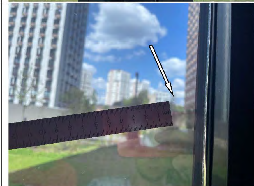
Фото №44. На стеклопакете металлического оконного блока в детской имеется дефект (внутренний).
