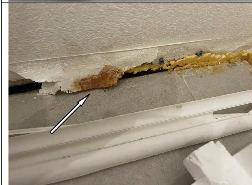
Фото №23. На стенах в коридоре найлены признаки поражений грибком.
