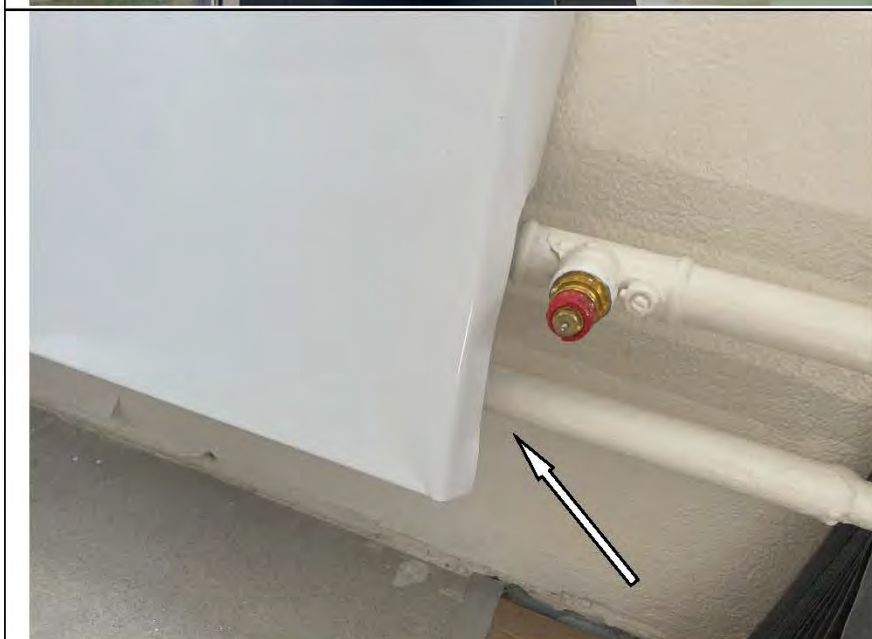
Фото №50. Кожух отопительного прибора в кухне-гостиной имеет дефект поверхности (деформация).
