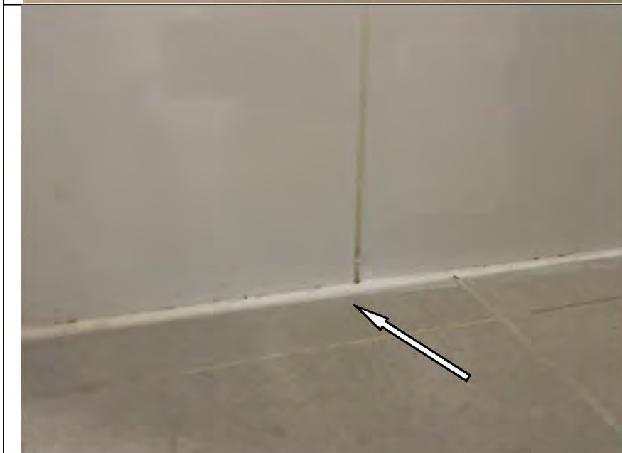
Фото №29. Загрязнение затирочным раствором напольной керамической плитки в ванной комнате.
