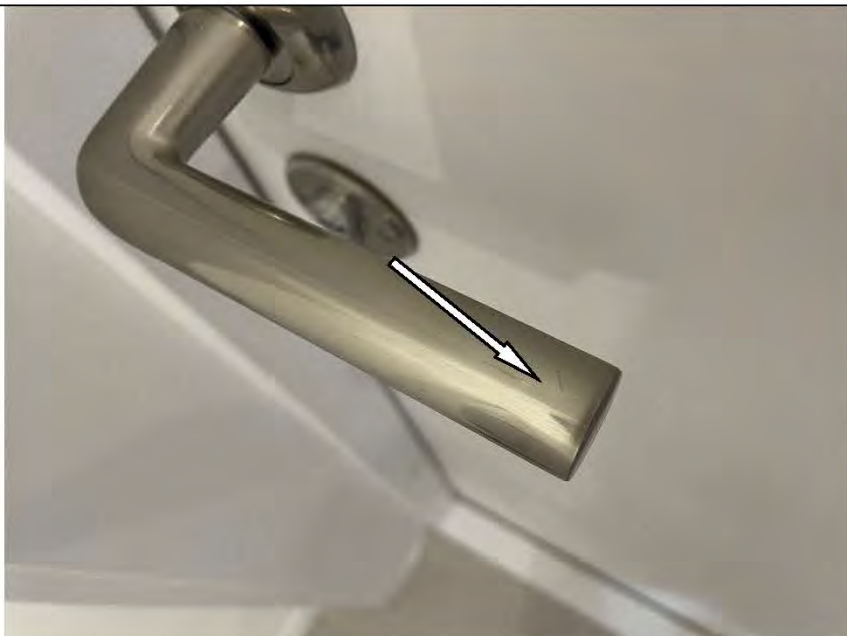
Фото №34. Царапины на фурнитуре входного дверного блока в коридоре (ручке).
