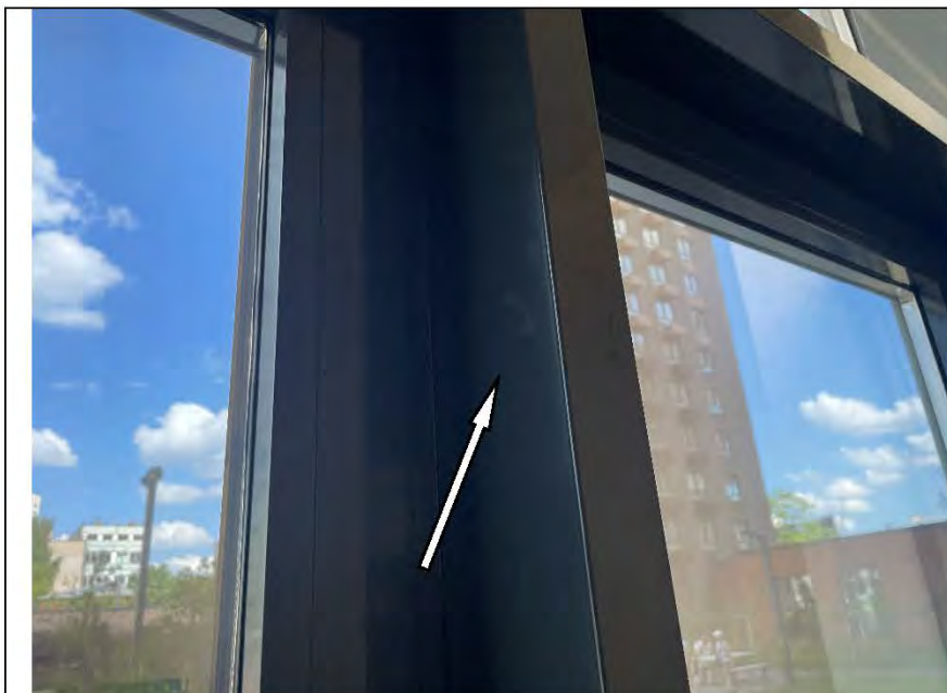
Фото №49. Дефекты на металлическом профиле оконного блока в кухне- гостиной (царапины).
